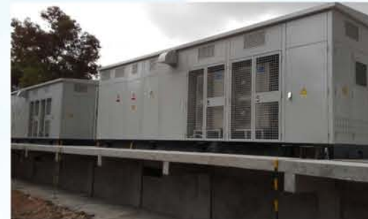
▼ 珠海银隆新能源电动大巴充电站预装式箱变
