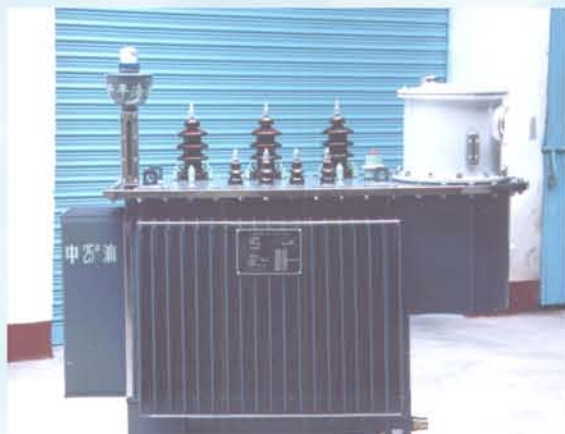
▼分裂式变压器
