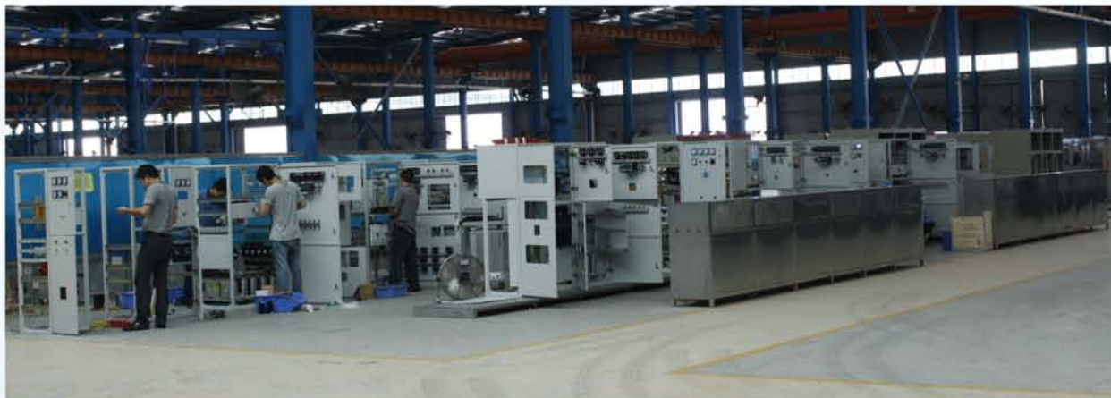
▼ 组变低压GGD柜
