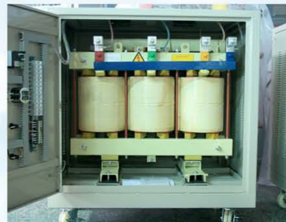
▼ 分裂式变压器
