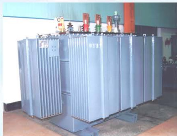
▼分裂式变压器
