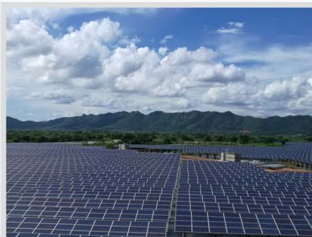
台山光伏项目
